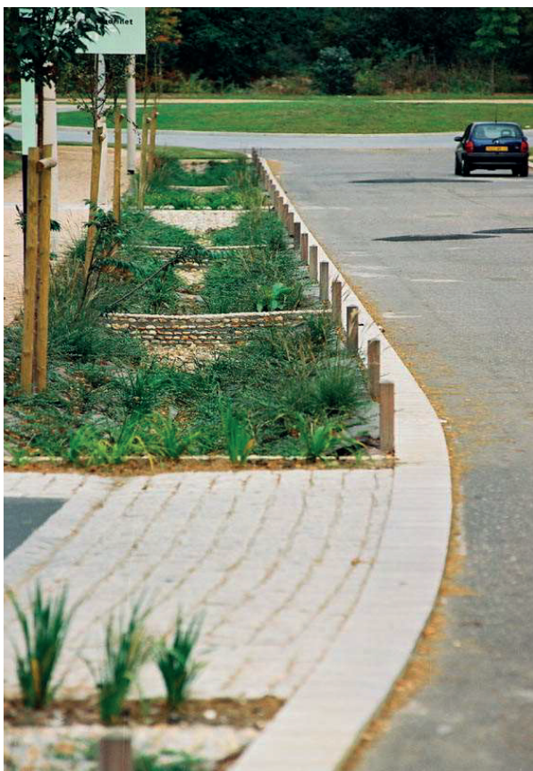
Noie à redents, technopole du Madrillet à Saint-Etienne de Rouvray (© Infra Service)
